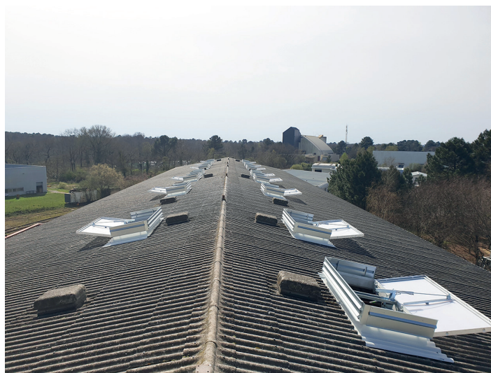
Test d'ouverture des DENFC en toiture du bâtiment Smurfit Kappa à Cestas (FR-33)
